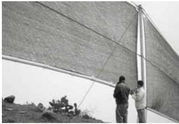
Kräftiger Wind im Hochland beansprucht die Nebelnetze stark. Das Bild zeigt zwei Mitarbeiter bei der Inspektion von Rissen an der Aufhängung.
